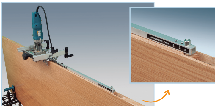
Entaillage sur l'ouvrant, 2 ème paumelle. Règle de division avec doigt palpeur, écartement réglé pour 3 ou 4 entaillages symétriques.
