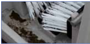
Bac de récupération des eaux usées
